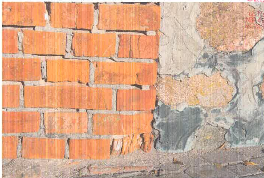
Zdjęcie 6 Wadliwie wykonane fugi słupów oraz parkanu
