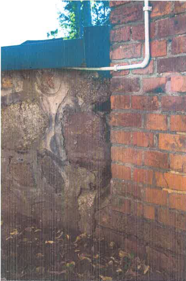
Zdjęcie 4 Ubytki fugi cementowo-wapiennej w parkanie kamiennym
