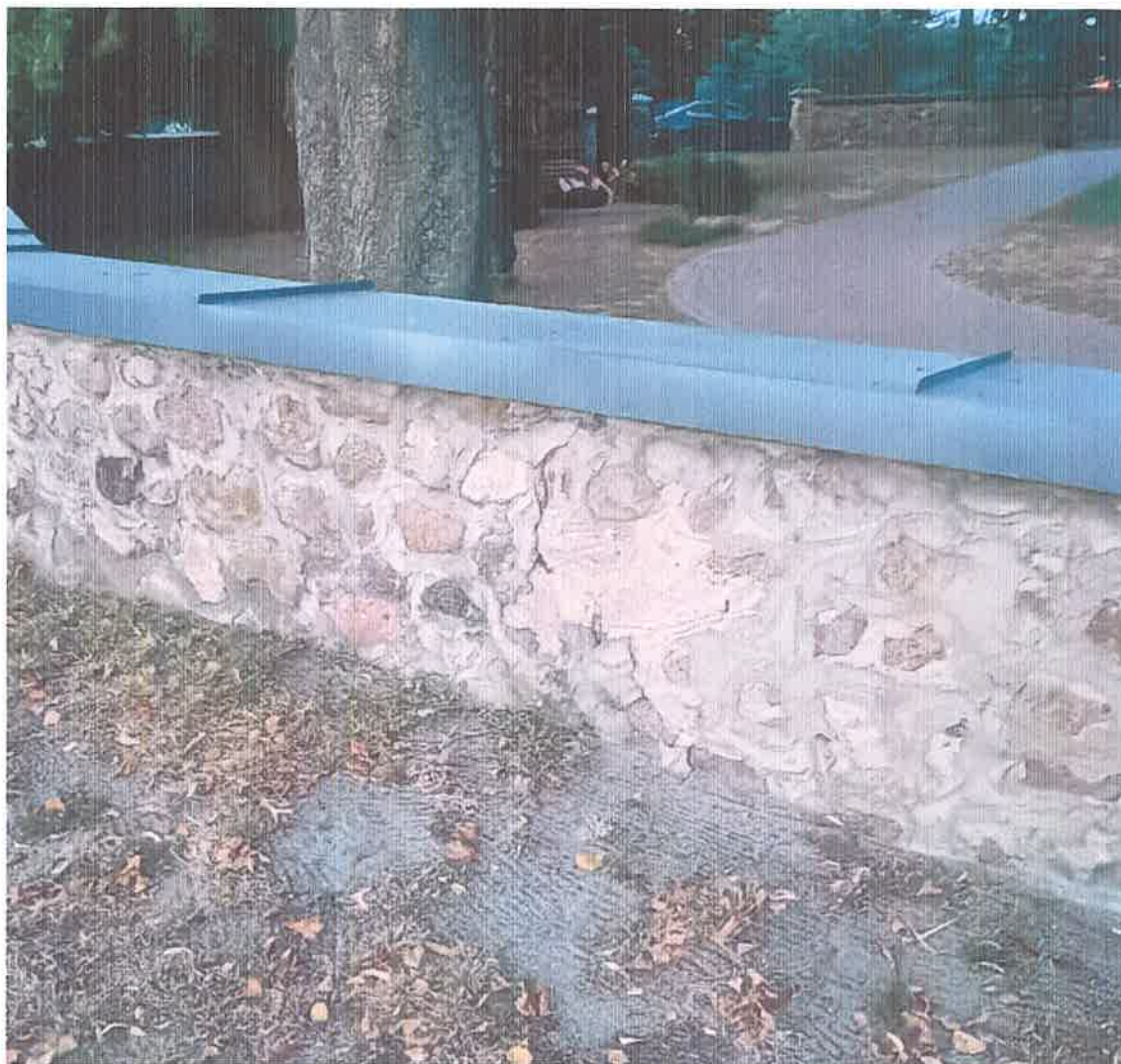
Zdjęcie 7 Uszkodzony parkan kamienny z wadliwie wykonanymi fugami kamiennymi
