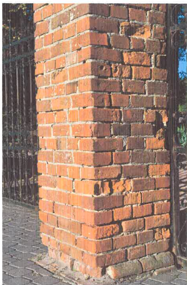
Zdjęcie 3 Ubytki w strukturze cegły
